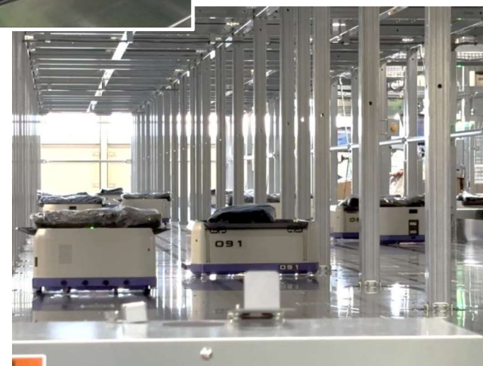
ソーター設備
